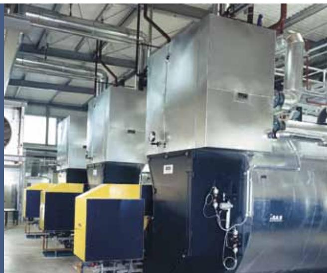
Figure 2: Exemple d'installation dans une usine de papier – 3 chaudières à vapeur avec surchauffeurs
