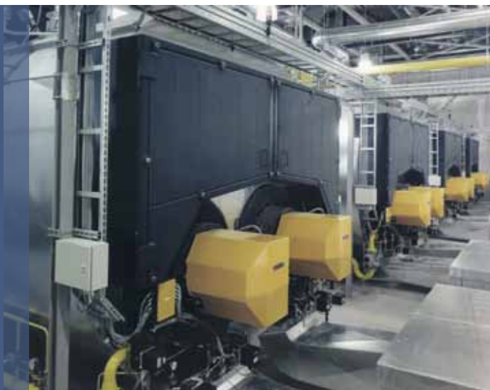
Figure 1: Photo d'installation avec 4 ZFR
