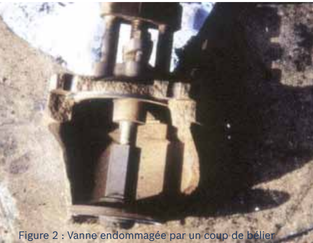
Figure 2 : Vanne endommagée par un coup de bélier
